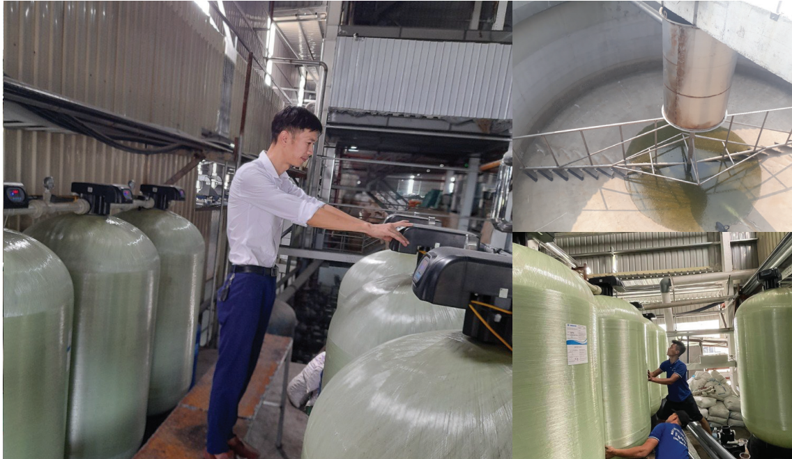
Hệ thống xử lý nước cho nhà máy sợi Vikohasan - KCN Đồng Văn VI, Hà Nam
